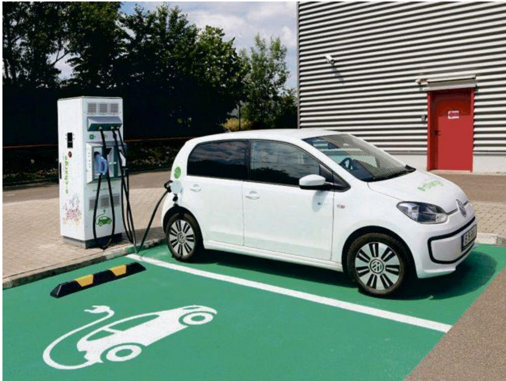
Figura 46 - Stație electrică de încărcare
